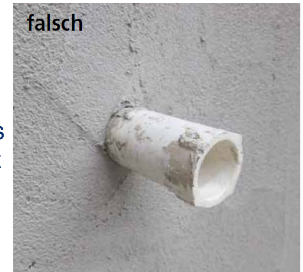
Eingeputzter Baustopfen, an welchem man nicht fachgerecht abdichten kann.
